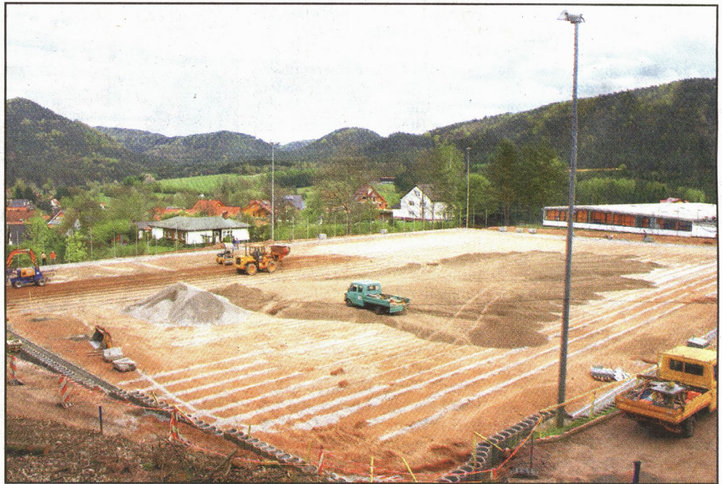
Mittwochs, freitags und an den Samstagen legen die Vereinsmitglieder des TuS Erfweiler beim Bau ihres neuen Rasenplatzes kräftig Hand an. (Foto: Johann)
